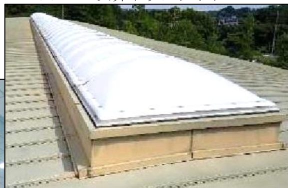
▼プール天井トップライト
